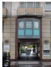
Abb. 14 Sanierungsbedürftige Fassade in der Kaiserstraße
