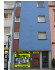
Abb. 27: Fassade mit bau-lichen und gestalterischen Defiziten in der Herrnstraße
