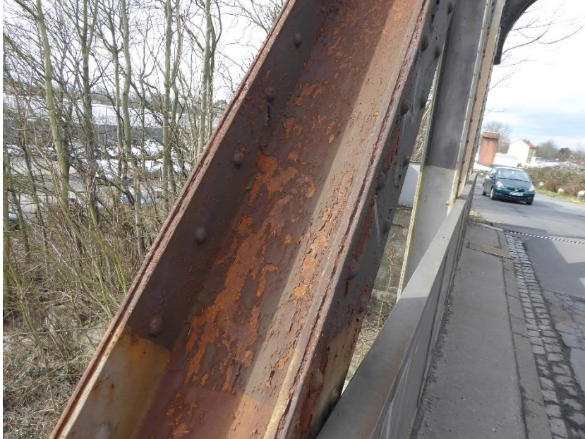
Abbildung 6: Korrosion zwischen genieteten Blechen
