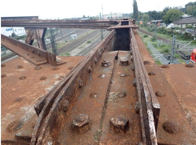
Abbildung 8: Korrodierte Rahmenecke, Sicht auf Oberseite
