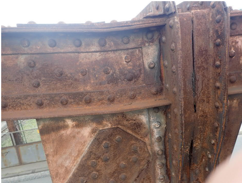
Abbildung 7: Korrodierte Rahmenecke, seitliche Ansicht
