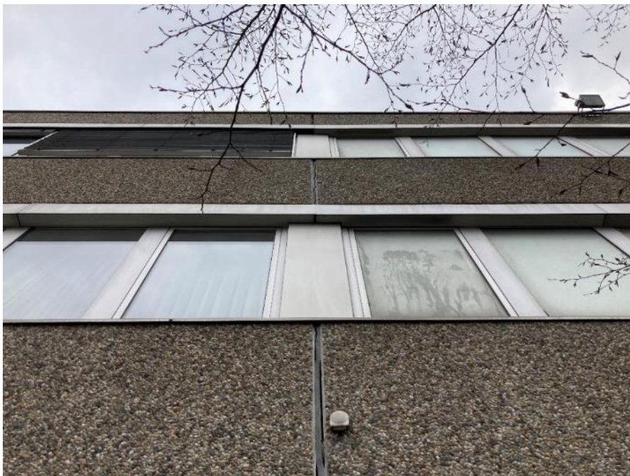
Foto 38: An der nördlichen Gebäudeseite sind die Gummiverkleidungen zwischen den Waschbeton-Platten teils verformt, sodass hier deutliche Spaltstrukturen bestehen, welche von Fledermäusen potenziell als Quartier genutzt werden können.
