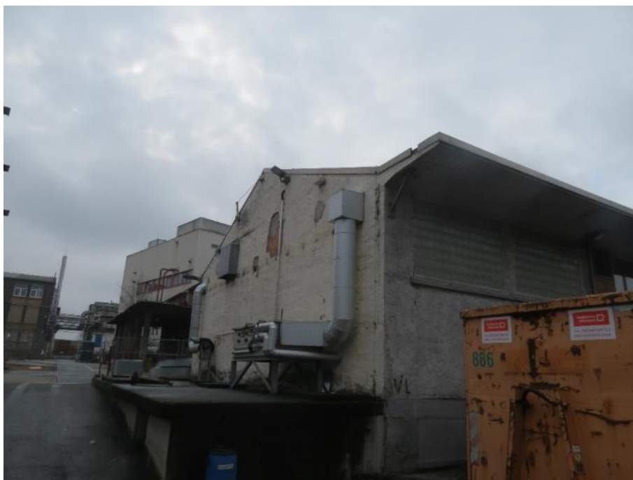
Foto 26: Produktions- und Lagergebäude Nr. 13 weist ebenfalls im Bereich der Attika, stellenweise auch beschädigt, Quartiermöglichkeiten für Einzeltiere aus der Gruppe der Fledermäuse auf.
