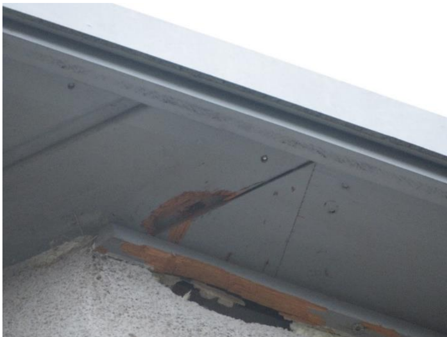
Foto 4: Im Bereich des holzverkleideten Dachüberstands finden sich vereinzelt Spaltstrukturen, welche potenzielle Quartiere für Fledermäuse darstellen. Ein unmittelbarer Nachweis ergab sich nicht.
