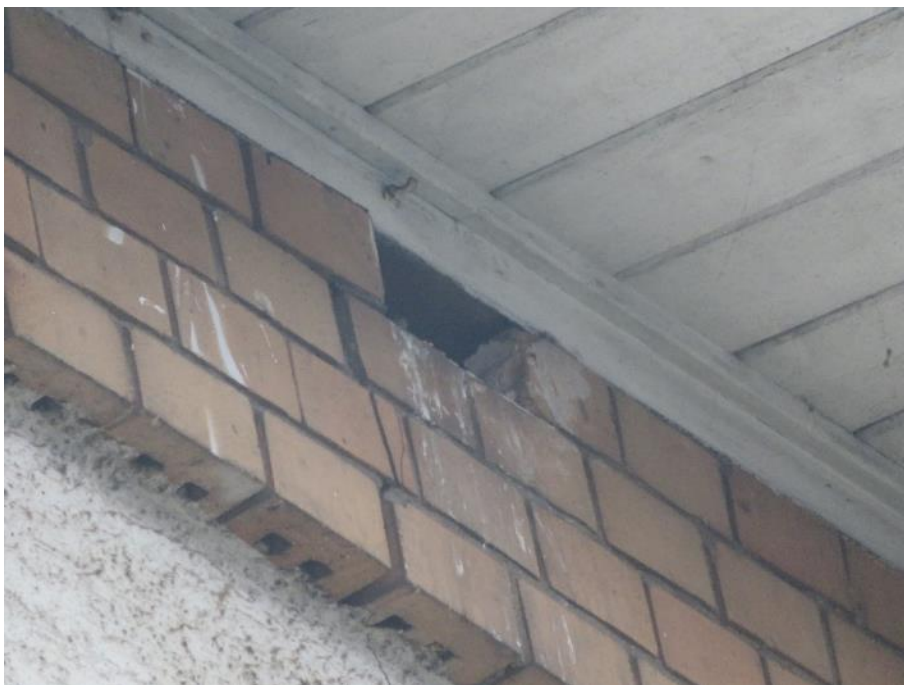
Foto 13: Der Hohlraum eines ausgebrochenen Backsteins unterhalb des Dachüberstands an der südlichen Seite des Gebäudes wurde in der Vergangenheit stark von Vögeln frequentiert und mindestens als Sitzplatz genutzt, wie die deutlichen Kotspuren belegen.
