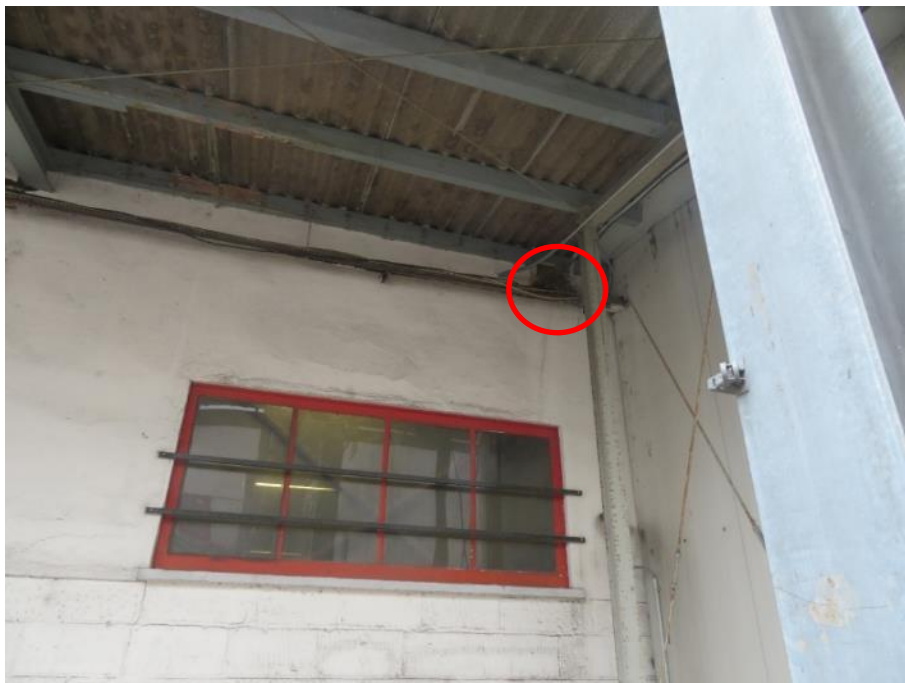
Foto 43: Aufgelagert auf ein Stahlträger-Gerüst wurde ein altes Tauben-Nest vorgefunden am Übergang zum angebautem Gebäude Nr. 52.
