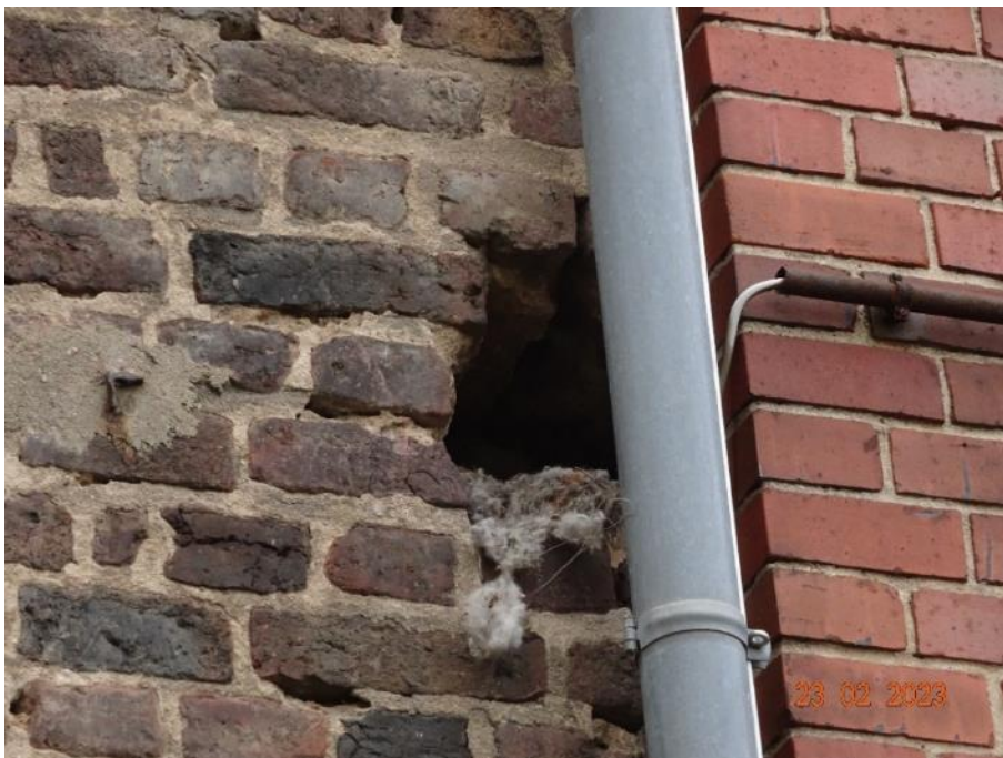
Foto 33: Hinter der Regenrinne findet sich ein größerer Hohlraum, welcher in der Vergangenheit möglicherweise als Brutplatz genutzt wurde.
