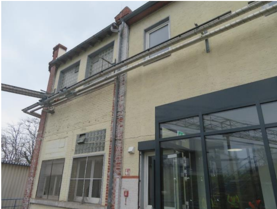
Foto 34: Das Kantinegebäude Nr. 16 weist ebenfalls zahlreiche Risse, Nischen und Hohlräume im Bereich des Dachübergangs sowie der Fassade auf, welche von artenschutzrechtlicher Relevanz sind. An den Fenstern im Erdgeschoss der südlichen Fassade sind zudem Raffstores angebracht die ggf. als Hangplätze für Fledermäuse dienen können.
