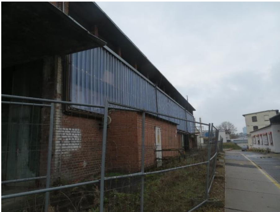
Foto 28: Gebäude Nr.11 kommt an der Außenfassade insgesamt nur ein geringes Potenzial zu.
