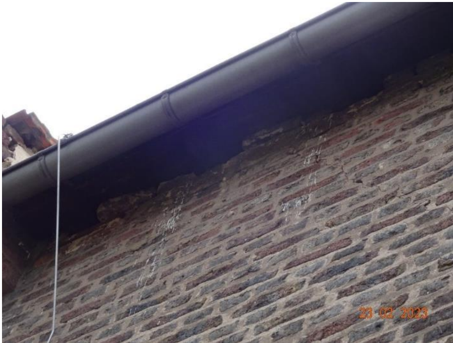
Foto 32: Unterhalb des Dachüberstands an der Nordseite finden sich mindestens sechs alte Brutplätze, wie anhand der deutlichen Kotspuren zu erkennen ist.
