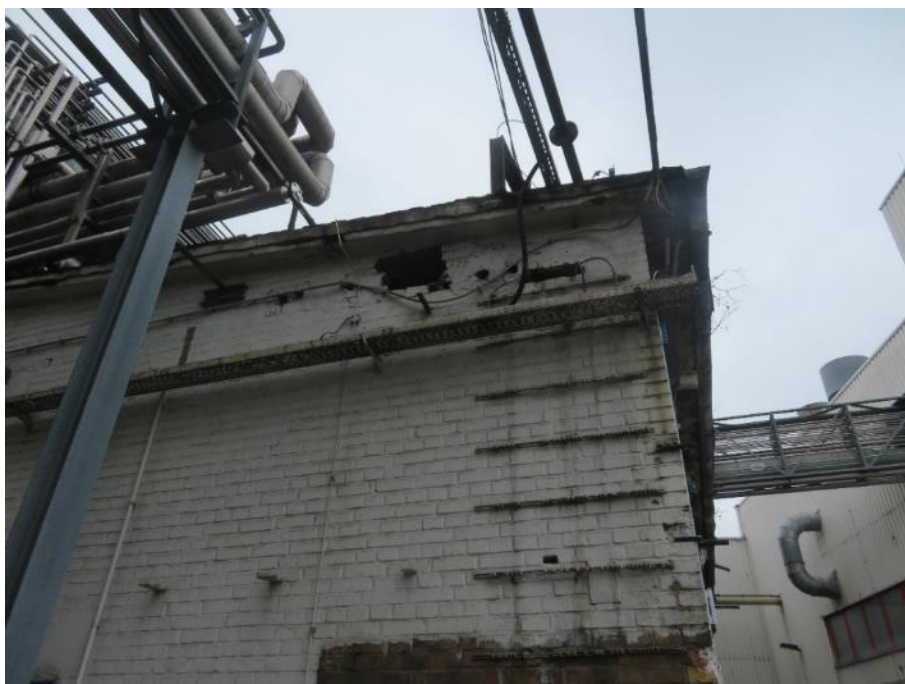
Foto 22: Das außer Betrieb befindliche Backsteingebäude Nr.7 weist starke Beschädigungen an der Fassade auf, wodurch ein Einflug ins Innere ermöglicht wird.
