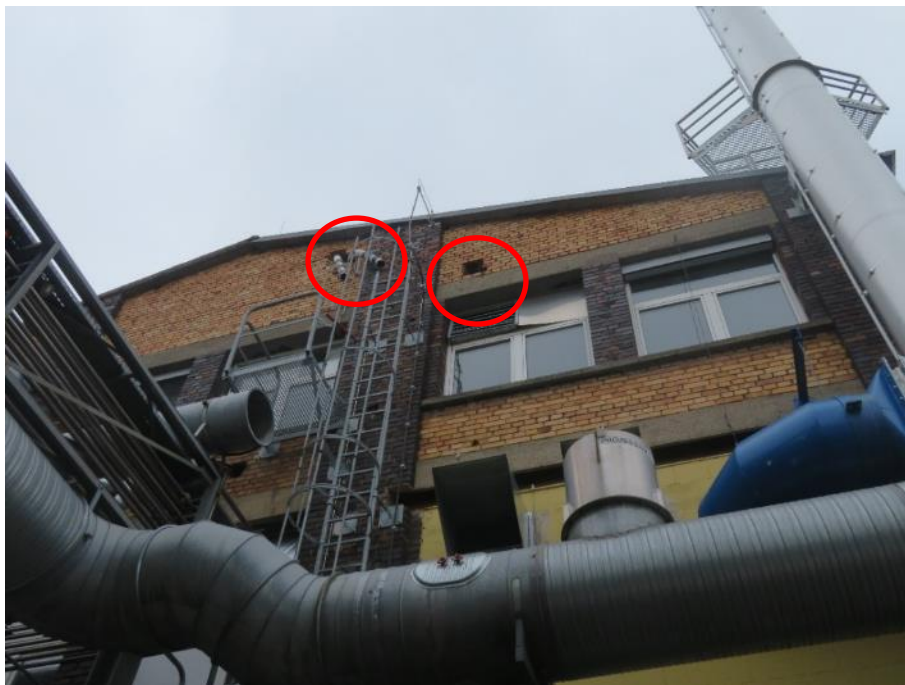
Foto 20: Öffnung an der westlichen Fassadenseite des Gebäudes Nr. 6 im Bereich austretender Rohre. Zudem weist die Backsteinfassade mehrere Schäden auf, durch welche sich kleine Nischen und Hohlräume bieten.
