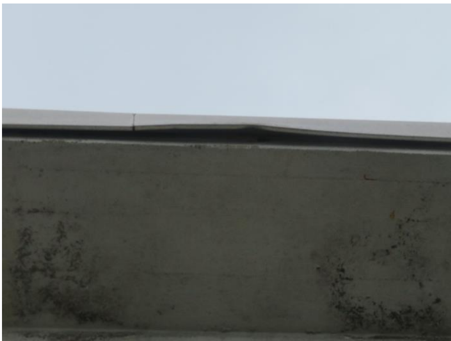
Foto 26: An einer Stelle der Attika wurde ein größerer Hohlraum vorgefunden, welcher Fledermäusen ggf. erlaubt unter der Attikaverkleidung Quartier zu beziehen.
