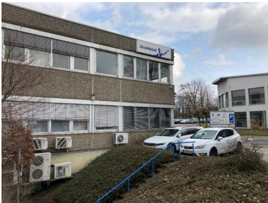
Foto 37: Bürogebäude Nr. 45 mit Potenzial für Hangplätze für Fledermäuse unterhalb der Attika verkleidung sowie an den Hohlräumen zwischen Mauerwerk und vorhandenen Raffstores
