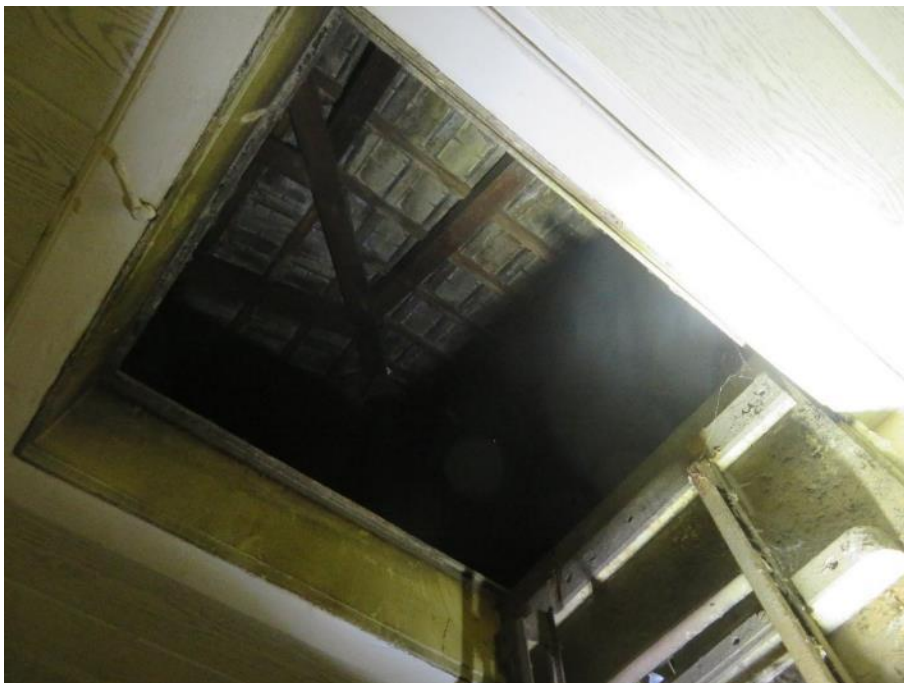
Foto 15: Der Dachboden konnte aufgrund der Einsturzgefährdung nicht weiter begutachtet werden. Dieser bietet potenzielle Hangplätze für Fledermäuse.
