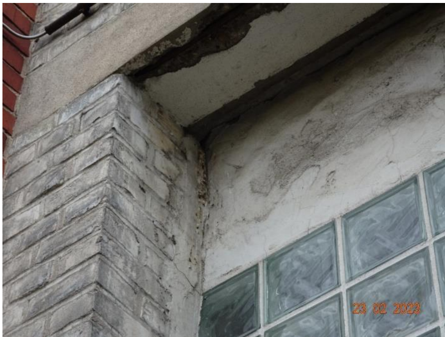
Foto 36: Oberhalb der Glasbausteine im Erdgeschoss an der Nordseite des Gebäudes befinden sich in beiden Ecken Nistplätze, erkennbar anhand der deutlichen Kotspuren.
