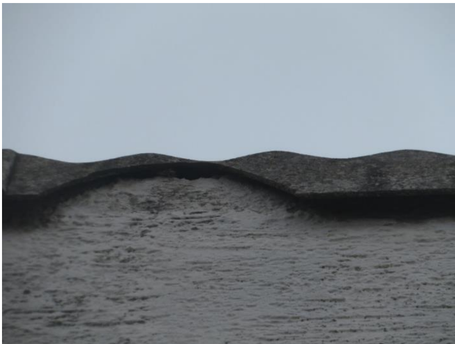
Foto 10: Die Attika weist an vereinzelten Stellen Beschädigungen auf. Auch für gebäudebrütende Vögel können größere Hohlräume, wie hier abgebildet, potenzielle Brutplätze darstellen. Hinweise auf ehemalige Nutzung in Form von Vogelkot liegen jedoch nicht vor.
