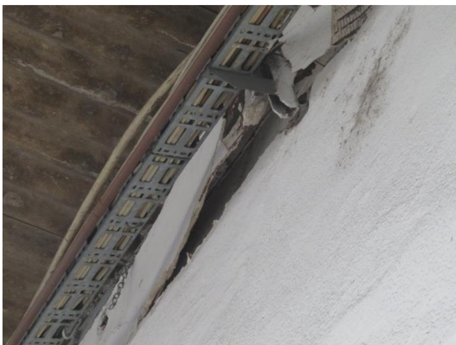
Foto 44: Die aufplatzende Fassade an Gebäude Nr. 52 stellt ein potenzielles Spaltenquartier für Fledermäuse dar.
