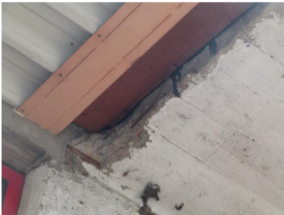
Foto 27: Unterhalb eines Hohlraums im Bereich einer Beschädigung des Vordachs aus Beton wurde Vogelkot vorgefunden, sodass davon auszugehen ist, dass die Nische in der Vergangenheit als Brutplatz genutzt wurde.
