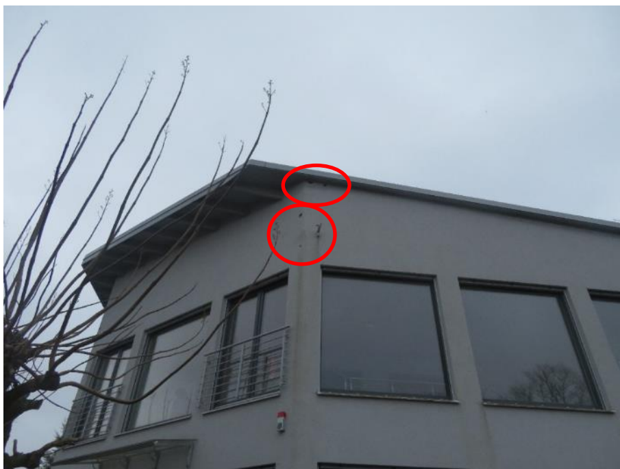
Foto 2: Die Fassade weist mehrere Spechtlöcher auf.
