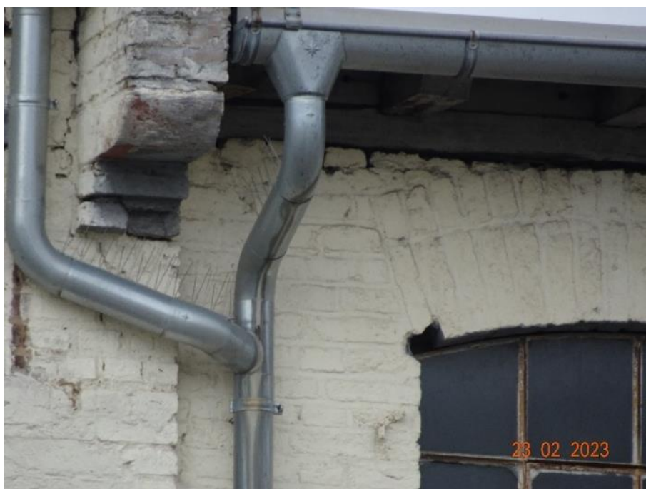
Foto 31: Dieses weist im Bereich des Dachüberstands sowie an ausgebrochenen Stellen der Fassade zahlreiche artenschutzrechtlich relevante Strukturen auf.
