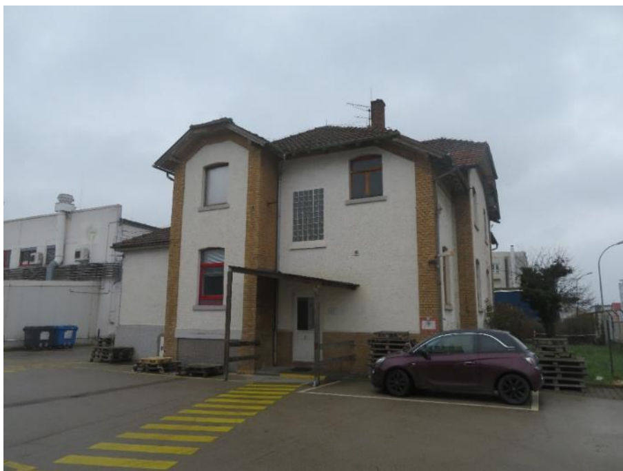
Foto 11: Dem Bürogebäude Nr.1 kommt ein sehr hohes Potenzial als Lebensstätte für Vögel als auch Fledermäuse zu. Es ist alt und bereits stark marode.
