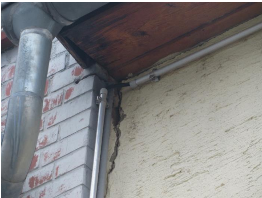
Foto 35: Deutliche Fassadenrisse aus der Nähe betrachtet mit Potenzial als Spaltenquartiere für Fledermäuse.
