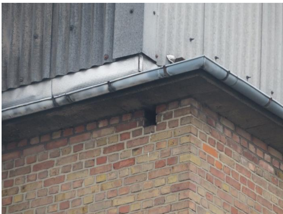
Foto 19: Am Turm des Gebäudes Nr.6 findet sich eine Nische aufgrund fehlender Backsteine. Vogelkots Spuren deuten auf eine regelmäßige Nutzung durch Vögel mindestens als Sitzplatz hin. Möglicherweise handelt es sich um einen Brutplatz. Unter der Wellblechverkleidung können Fledermäuse potenziell Quartier beziehen.
