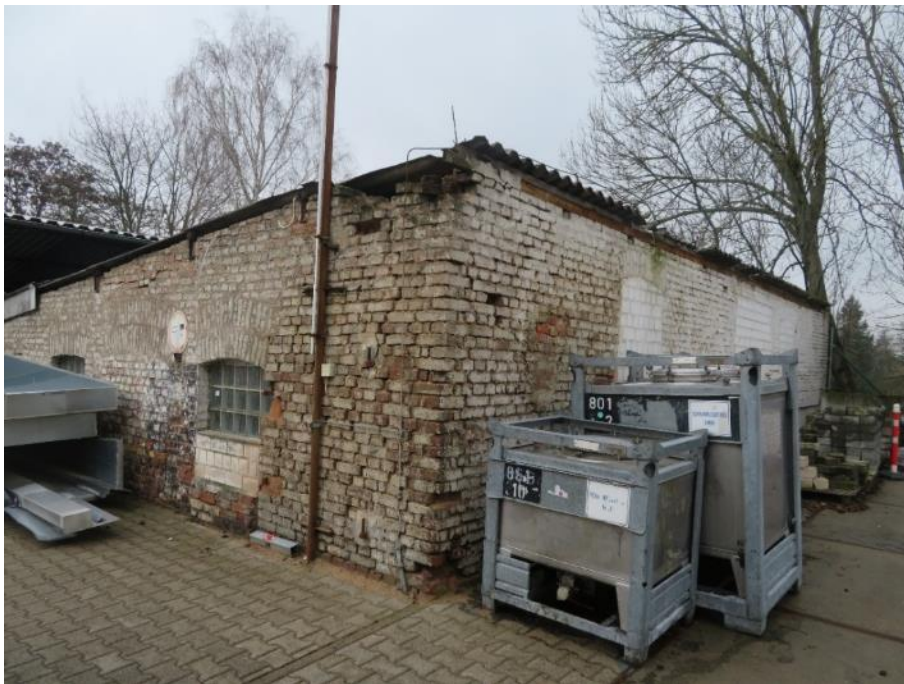
Foto 41: Gebäude Nr. 59 ist stark marode. Möglicherweise bieten sich Quartiermöglichkeiten unterhalb des Wellblech-Daches und zwischen dem Mauerwerk.
