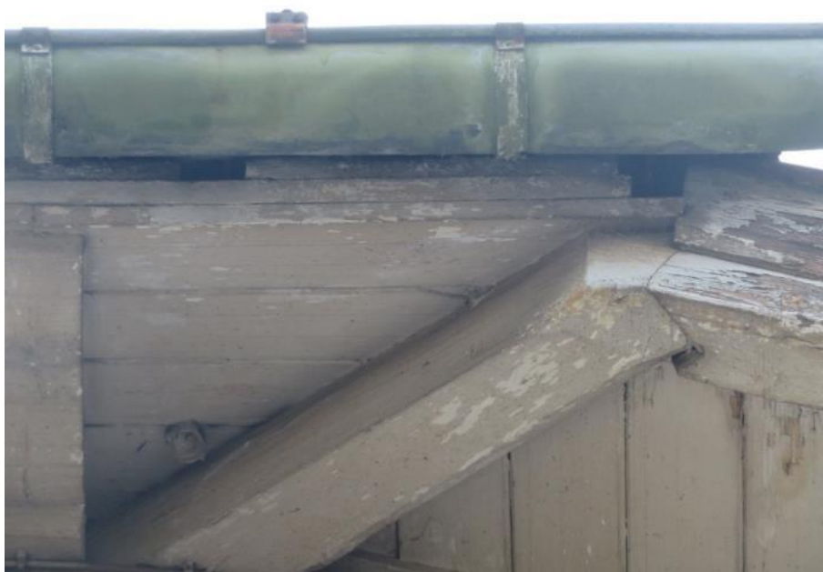
Foto 12: Der holzverkleidete Dachüberstand weist aufgrund des maroden Zustands des Gebäudes zahlreiche Öffnungen und Spalten auf.
