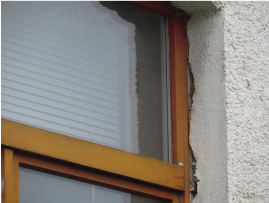
Foto 14: Potenzielle Spaltenquartiere für Fledermäuse an ausgebrochenen Fassadenstellen rund um die Fenster.
