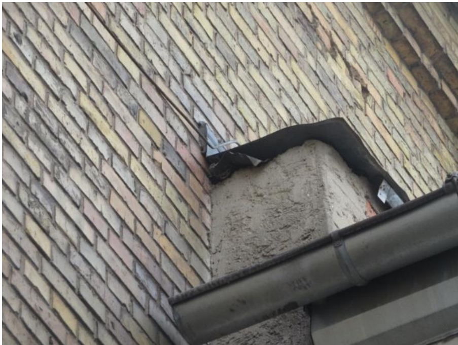
Foto 25: Unterhalb der Blechverkleidung eines Fassadenvorsprungs bietet sich Potenzial als Spaltenquartier für Fledermäuse und möglicherweise auch ein ausreichender Hohlraum als potenzieller Brutplatz von Gebäudebrütern.
