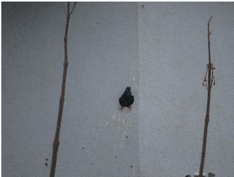
Foto 3: Bei der Begehung am 23.02.2023 wurde der Einflug von Staren in die Spechtlöcher beobachtet. Die starken Kotrückstände an der Fassade deuten bereits auf eine Nutzung als Brutstätte durch die Stare in der Vergangenheit hin.
