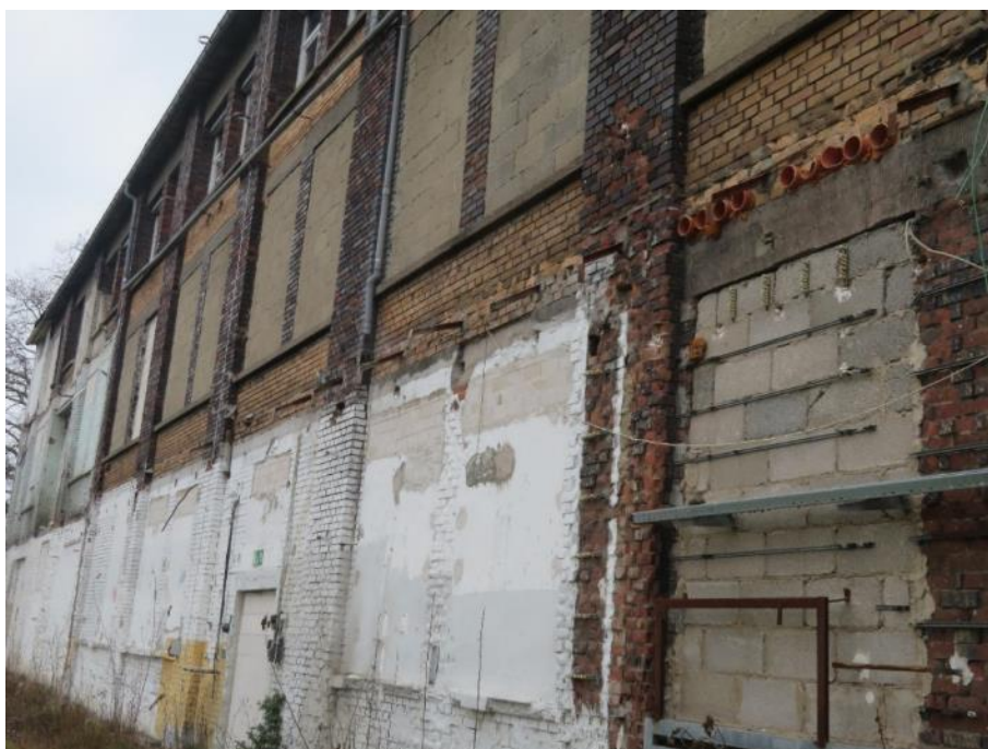
Foto 21: Auch die nördliche Fassadenseite ist stark marode und bietet in Bereichen ausgebrochener Backsteine potenzielle Brutplazue für Nischenbrüter.
