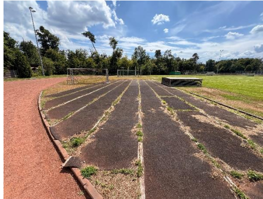
Bereiche der Anlage weisen Gefahrenpotenziale auf
