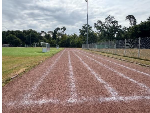
Der Belag der Laufbahn entspricht nicht mehr heutigen Standards
