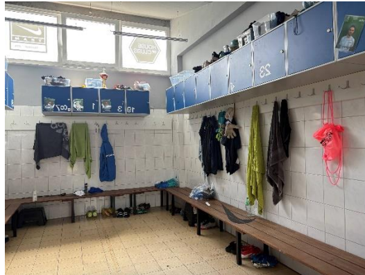
Die Umkleiden haben keine effiziente Lüftung
