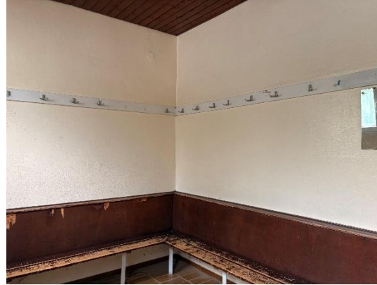
Die Umkleiden sind stark abgenutzt
