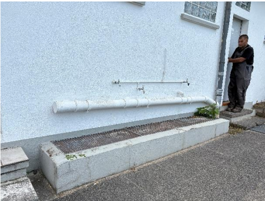
Die Bausubstanz ist veraltet und marode
